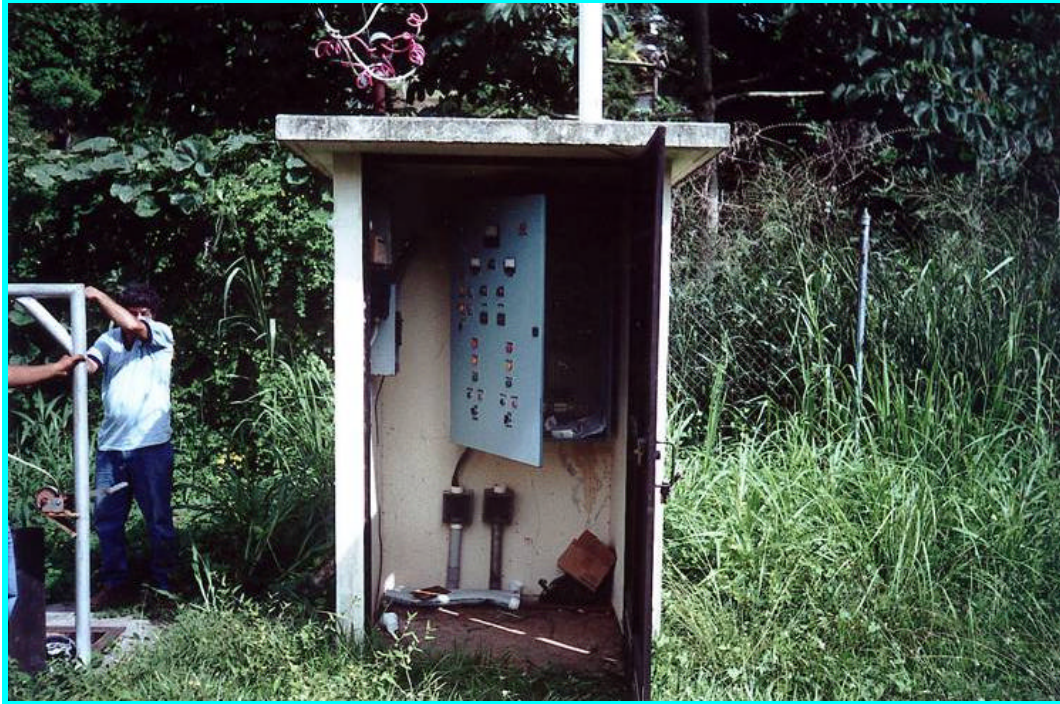
FotoNº2.2.8.11 -Estacióndebombeo deVilla Lucre. Condiciónactual(11de juliode 2000).
