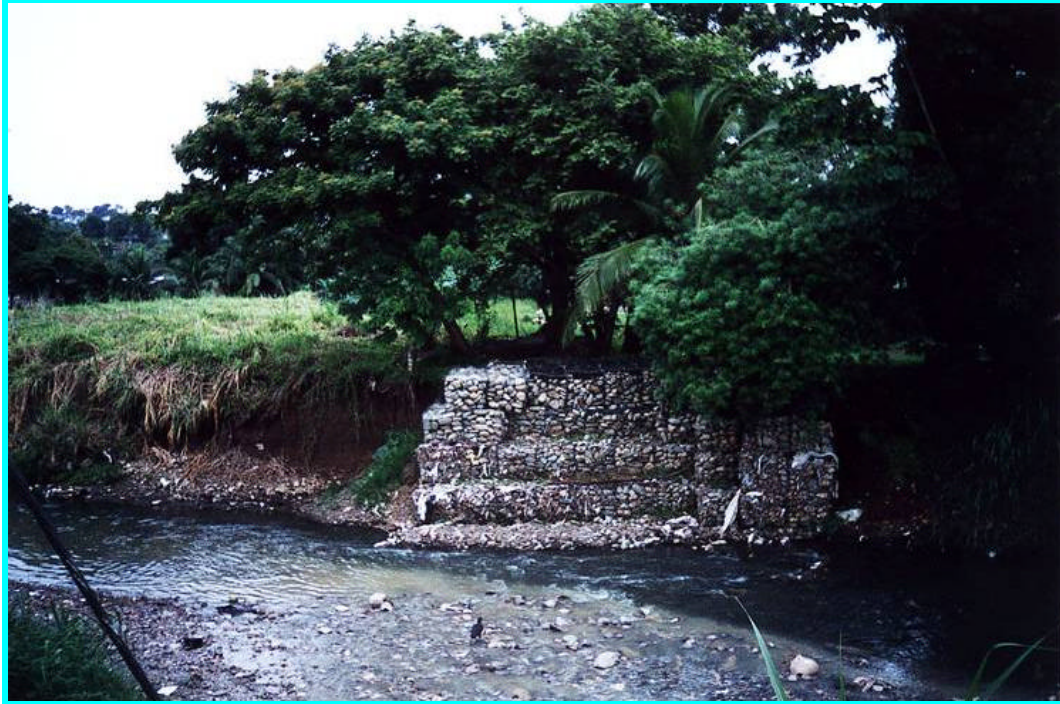
Foto N°2.2.8.5 -Sitio del daño del sifón en el cruce de la colectora en el sitio en las comunidades de Samariay Villa Lucre. Observar la colocación de los gaviones.
