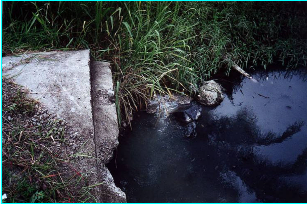
Foto N° 2.2.8.1 -Descarga por aliviadero en colector Matías Hernández, sitio de la Fontana, Reparto Nuevo Panamá. El sifón invertido será reemplazado
