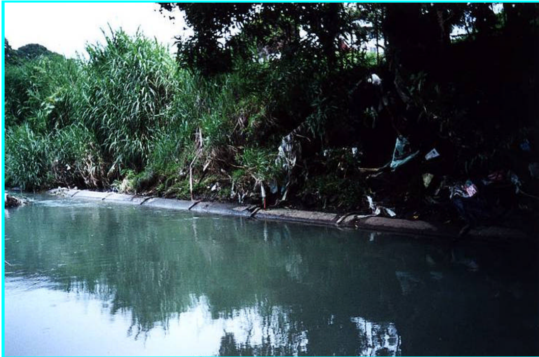
Foto N° 2.2.8.6 -Vista del tramo de tubería de 42" de hormigón al descubierto, tramo en Calle F, Parque Lefevre, al cual se le ha programado mejoras.
