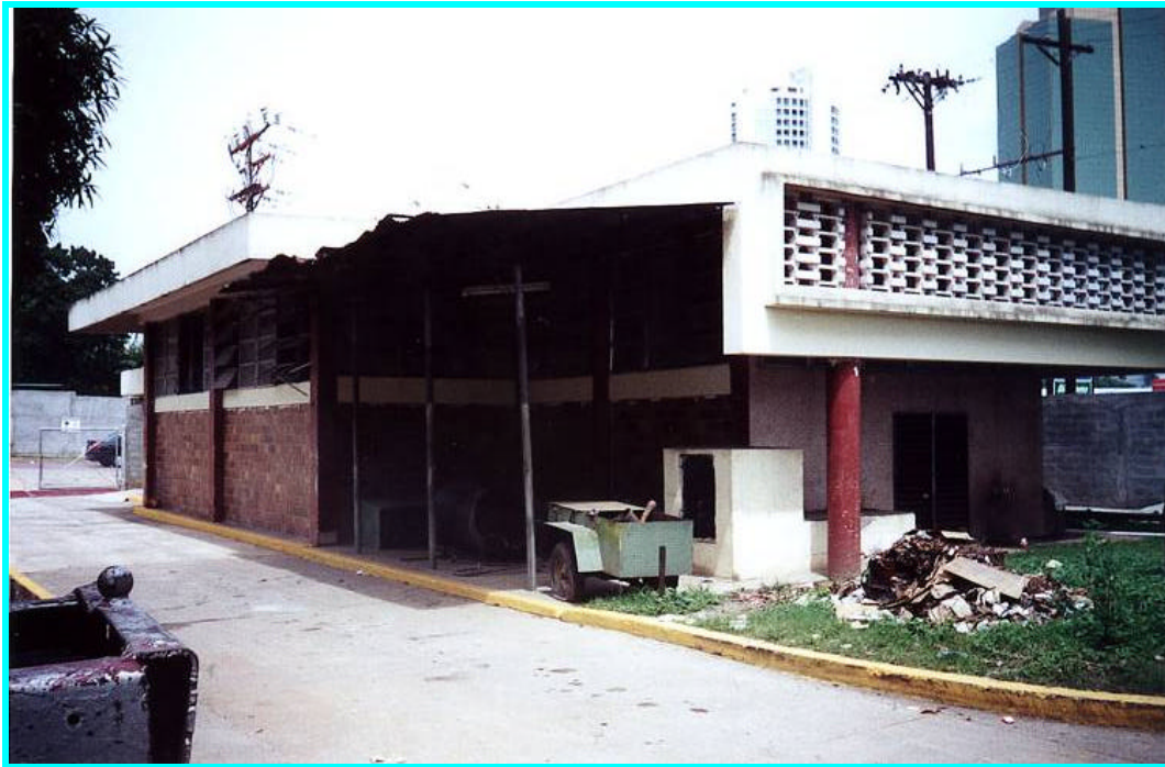
FotoNº2.2.8.13 -Estacióndebombeo de Vía Brasil, condiciónactual, 11 de juliode 2000.
