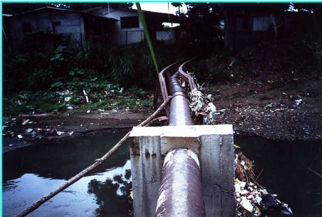
FotoNº2.2.8.4 -Cruce de la colector del Río Matías Hernández con cercha en Calle M, San Miguelito, condición actual, 12 de julio de 2000.
