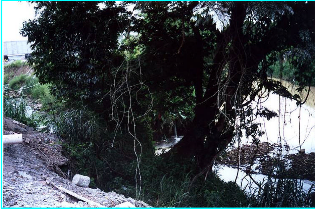
FotoNº2.2.8.7 -Descarga deaguasservidas alRío Palomo portuberíarota en la intercepción con QuebradaCuatro, afluentes delRíoJuan Díaz.
